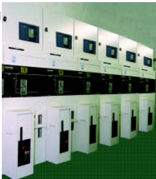
Единая система управления с помощью устройств Seram
