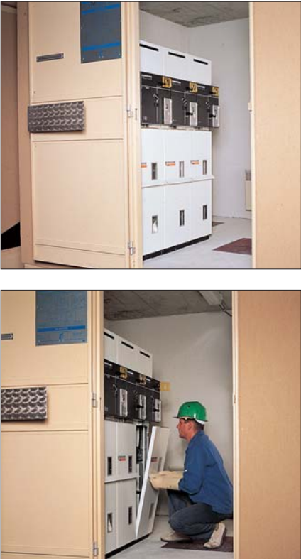
Комплектная подстанция заводского изготовления
